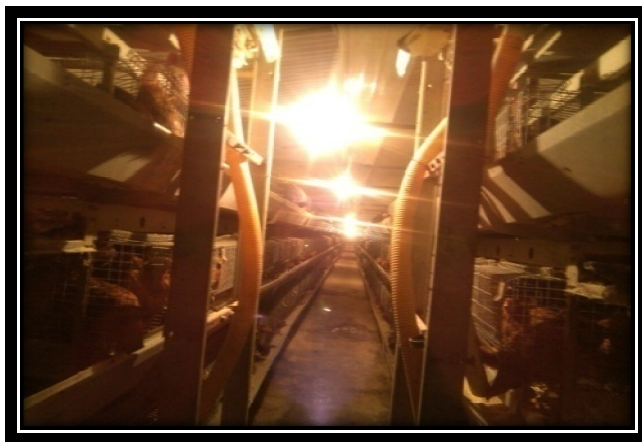
Figure n°14 : l’éclairage de bâtiment
