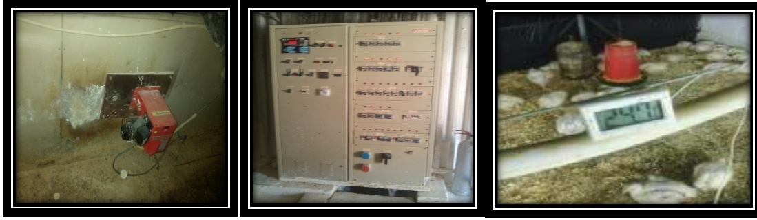
Figure n°11 : chaudière Figure n°12 : tableau de commande Figure n°13 : thermostat
