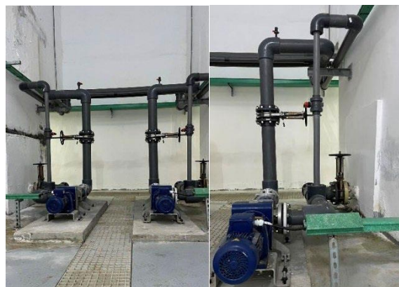
Figure 2.24. Pompes d'extraction de boue
