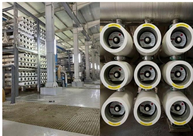
Figure 2.15. Les racks des membranes
