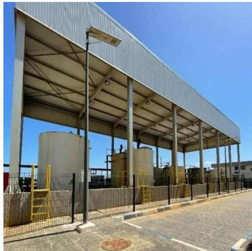
Figure 2.17. Réservoirs de stockage/Dosage
