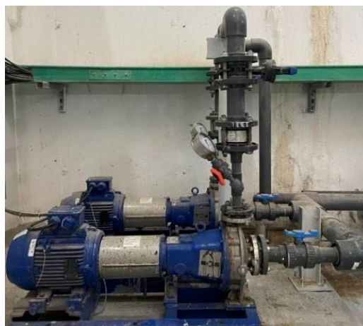
Figure 2.20. Pompes de javellisation
