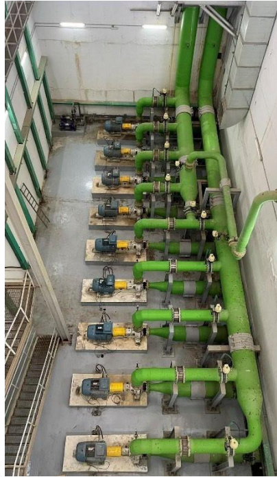
Figure 2.23. Pompes d'alimentation en eau brute
