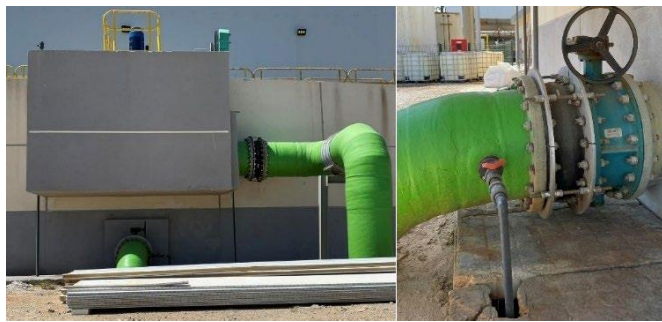
Figure 2.7. Bâche de coagulation
