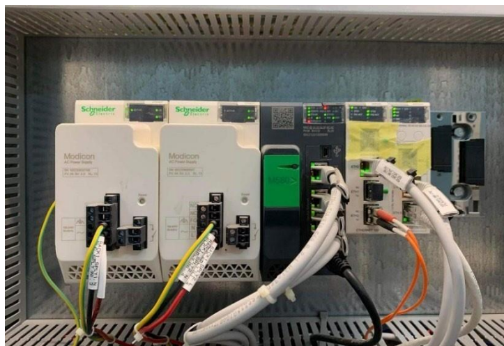
Figure 3.3. Panneau de contrôle automatisé
