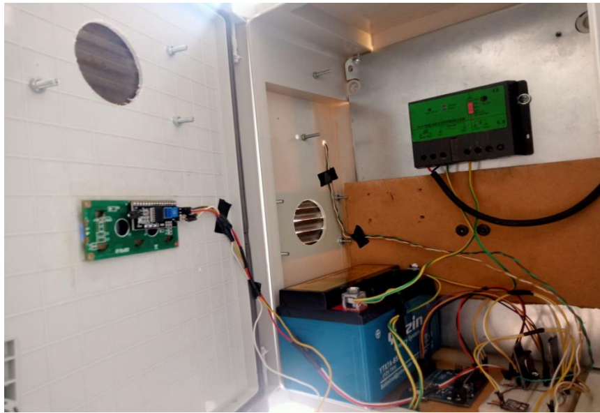
Figure (III.25): Connexion des capteurs utilisés dans la station.
