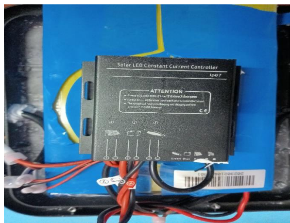
Figure (III.8) : Installation du contrôleur de charge
