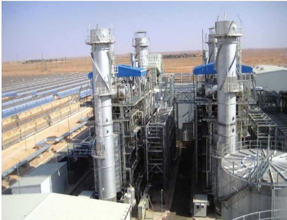
Figure (I.5) : Centrale Hybride Solaire-Gaz de 150 MW
