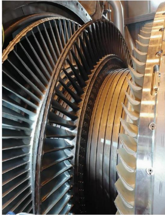
Figure II.8 : Ailettes de la turbine MS 9001FA remontées (avant l'amélioration)
