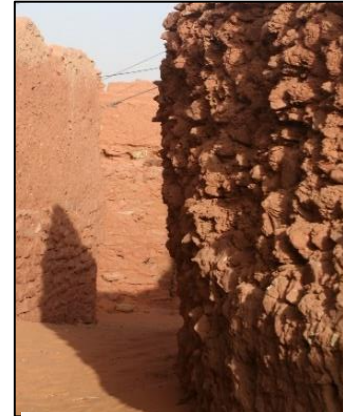
Figure 86: Mur crépisé. /Source: SADOUNE.L, 2024.
