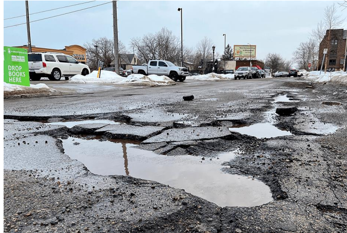
Figure 1.1 : Route endommagée avec nids-de-poule [1]
