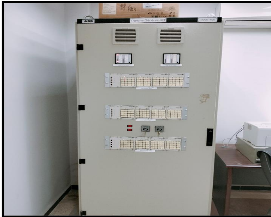
Figure III.1: la TG de poste SONLGEZ SIDI EI KBER
