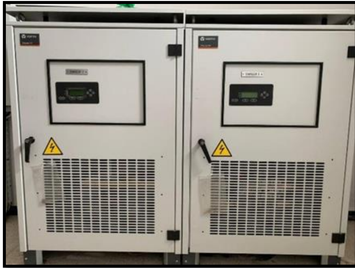
Figure III.7 : Redresseur de poste SIDI EL KBER
