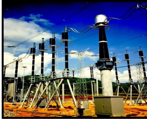
Figure II.22: Disjoncteur à haute tension
