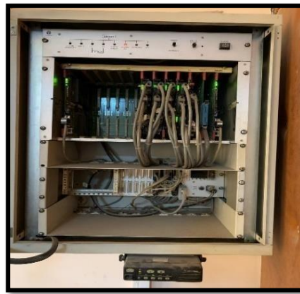
Figure II.10 : l'ancien poste commander par UHF.
