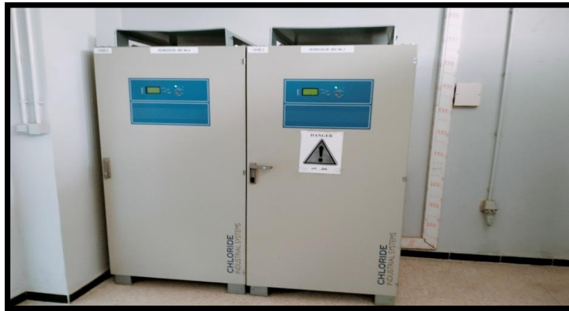
Figure III.6: Les batterie de poste SIDI El KBER
