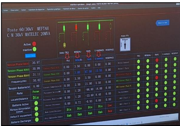
Figure II.3 : IHM d'un poste commandé par GPRS.
