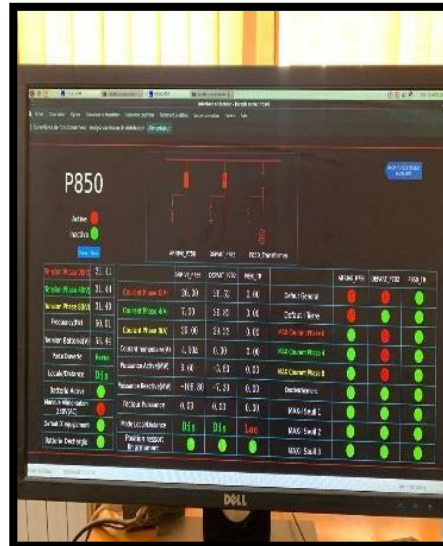
Figure II.15 : poste MT/BT commander par GPRS
