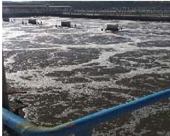
Figure 4: Un bassin d'aération de STEP de Baraki (photo original)
