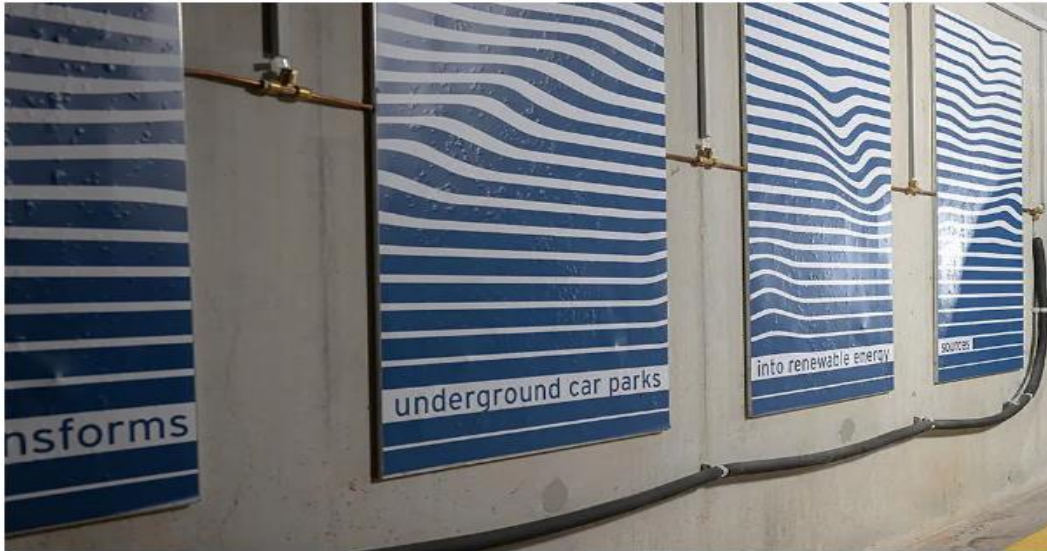
Figure II. 24 : plaque de récupération de chaleur installer dans un parking
