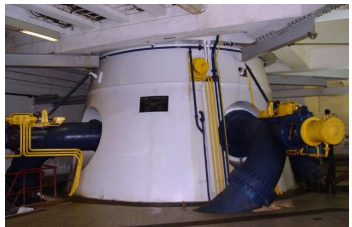
Figure 74 : Etage des turbines. (Source : Archives SPE Darguinah)
