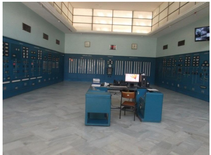
Figure 77 : La salle de commande (Source : Photo auteur)
