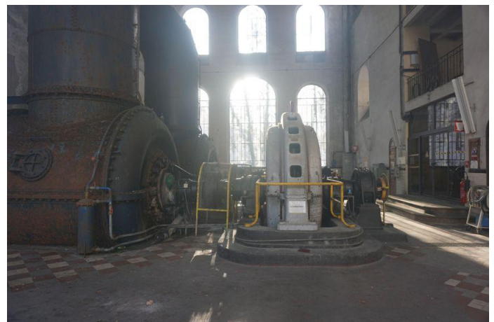
Figure 29 : La salle des Turbines (source : www.isere-patrimoine.fr )
