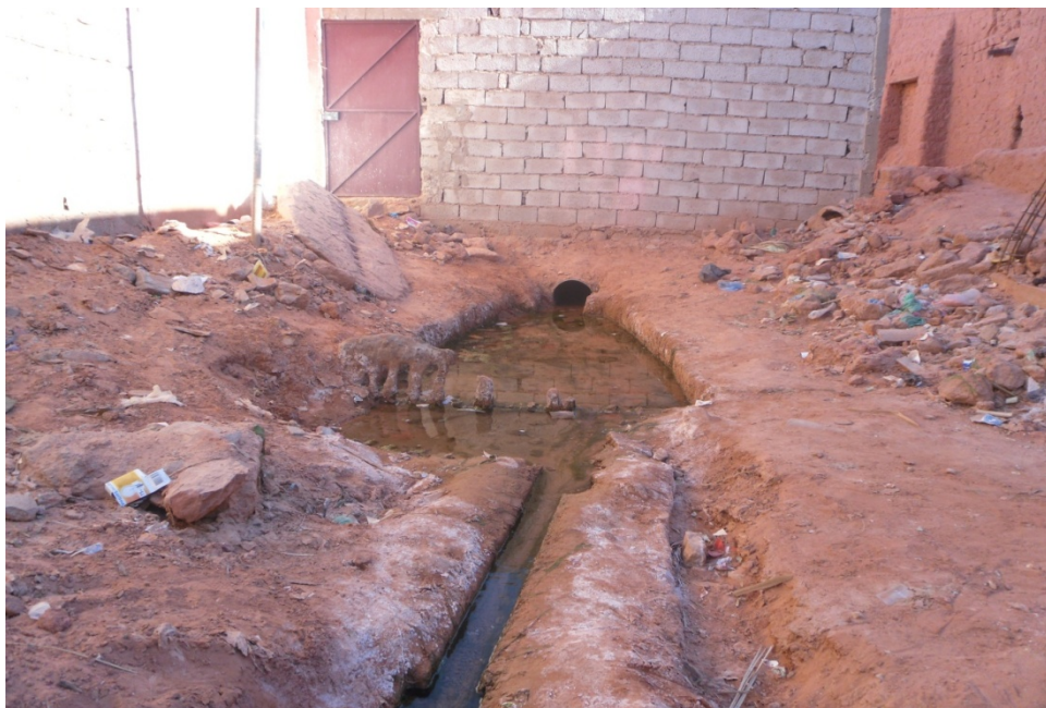
Fig. 3.11. Etat critique de foggara Ifli Amokrane de Timimoun
