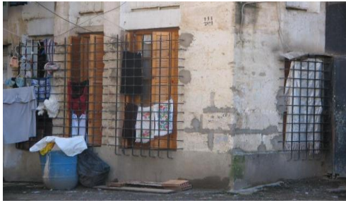
Figure 32 : fenêtre à Diar el mahçoul Source : Google image
