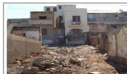
Fig.2.68 : dégradation de l'environnement des constructions au bord de mer.
