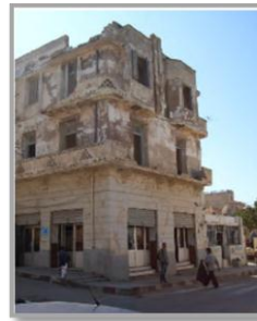
Fig.2.64 : dégradation et abandon des immeubles dans le centre ville.
