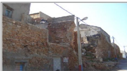
Fig.2.67 : dégradation de la façade maritime Nord-est du centre ville
