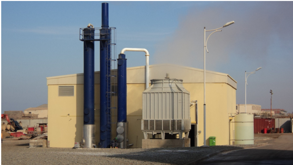
Figure V-13 : CO 2 fabriqué sur site, [source: MESLEK.F].
