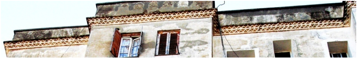
Figure. 4.39 : Les traces d'uniformisation de l'acrotère.
