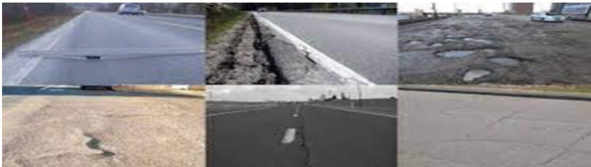
Figure I.19 : Des routes avec des fissures longitudinales.
