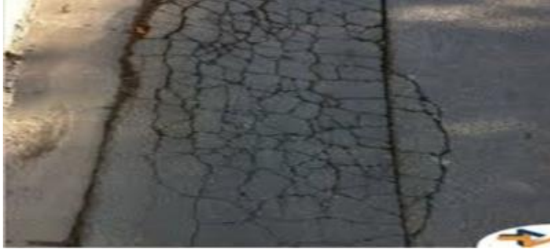
Figure I.29 : Route dégradé (coupe et tranchée)(10)
