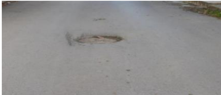
Figure I.30: Dénivellation des regards et des puisards (10)
