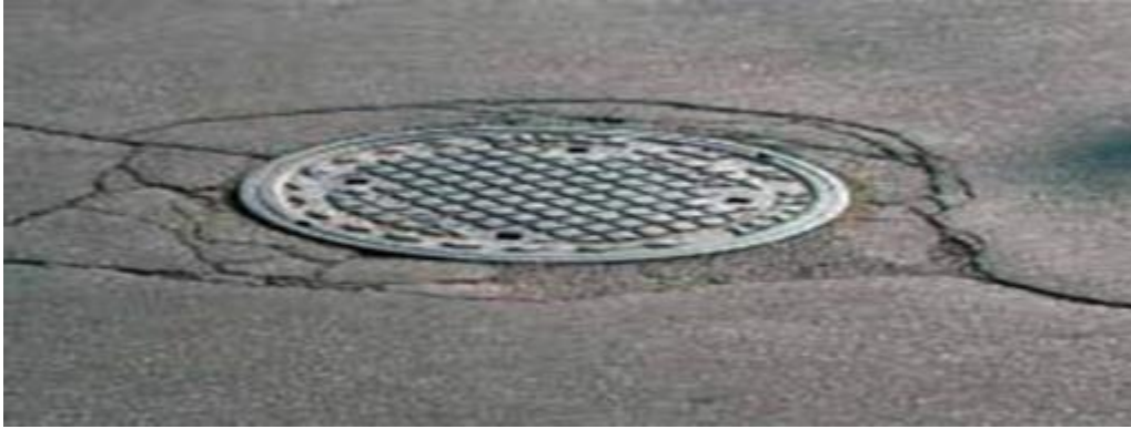
Figure I.28 : Dégradations à proximité d'un regard au niveau d'une route urbaine
