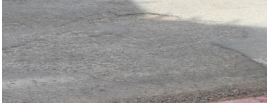
Figure I.25: Anomalies observées sur la RN 22 à l'entrée de Tlemcen
