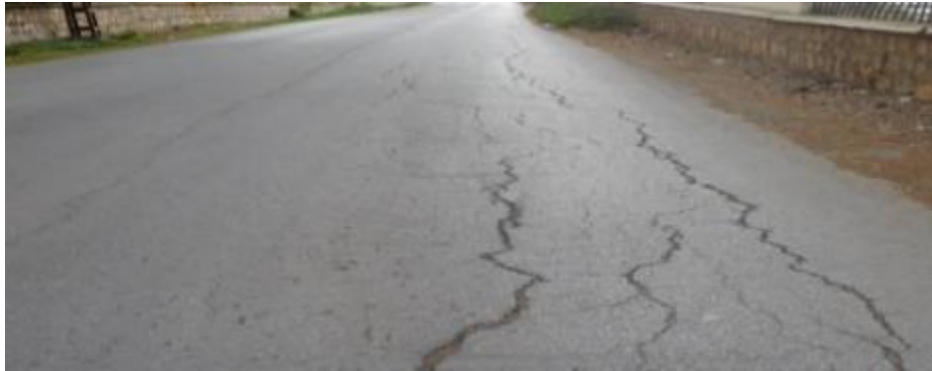
Figure I.20 : route de montagne avec fissure de gel.
