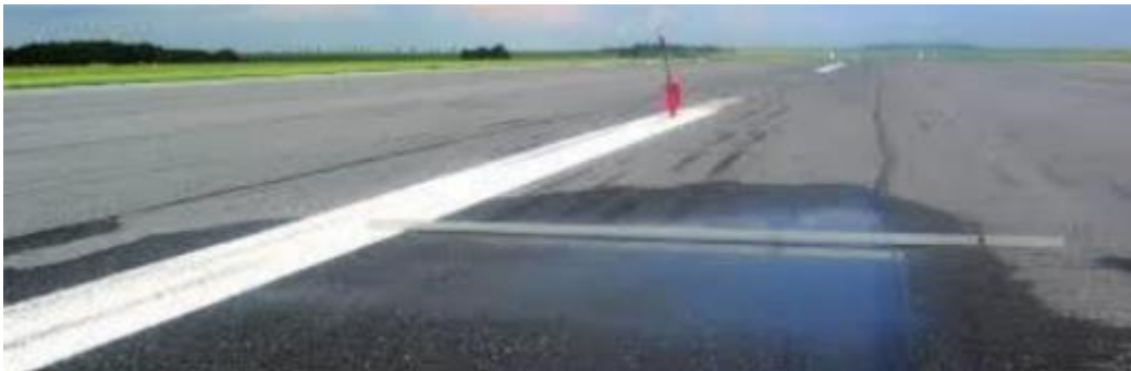
Figure I.17 : Route avec désordre du profil.(11)
