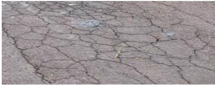
Figure I.23 : Anomalies dues au phénomène du faiençage
