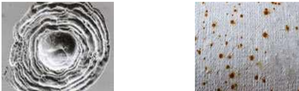
Figure II-2 : Corrosion par piqûres
