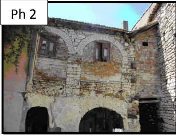
Photo2 : maison effondrée (la Casbah)
