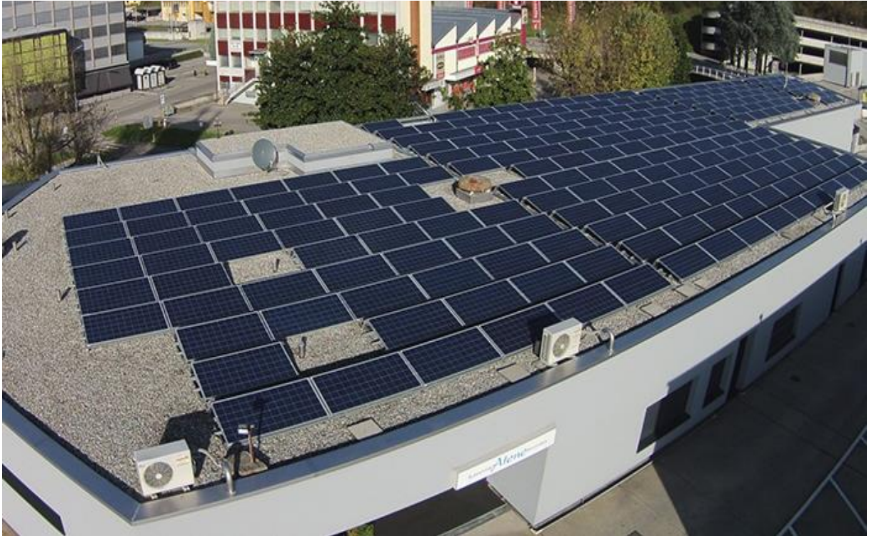
Figure 1.9 : L'installation photovoltaïque du centre commercial de Serfontana dans le Morbio Inferiore[28]
