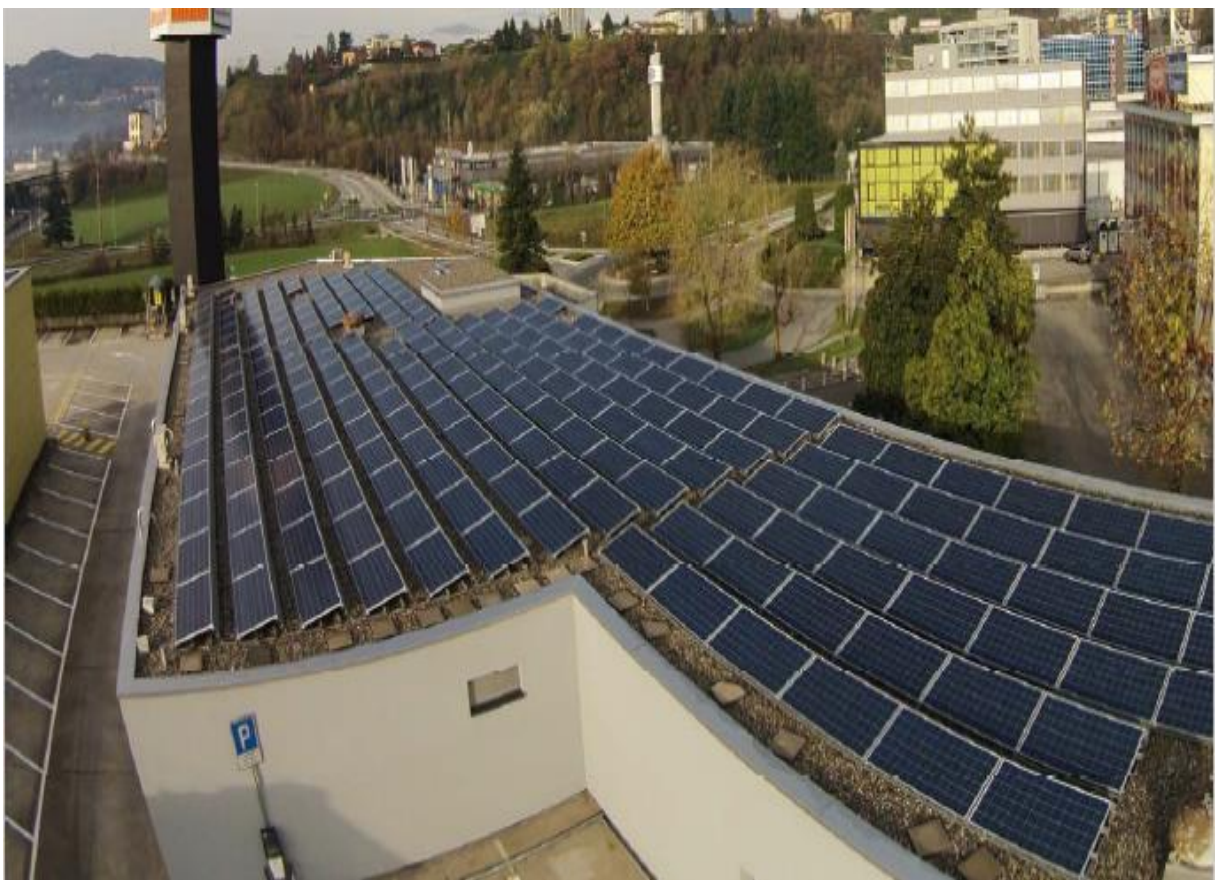
Figure 1.10 : L'installation photovoltaïque du centre commercial de Serfontana dans le Morbio Inferiore [28]
