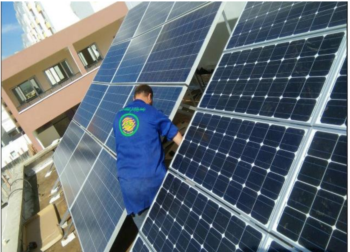
Figure 1.12 : Intégration du système PV dans une école à Annaba
