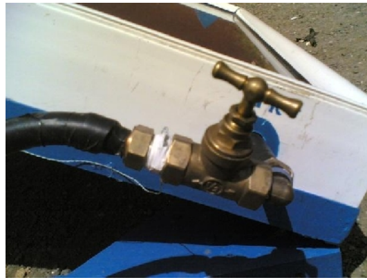
Figure (4-3) : vanne de réglage du débit
