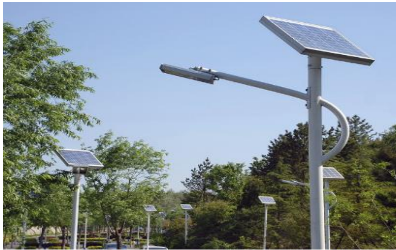
Figure 121 : éclairage public avec panneau solaire.
