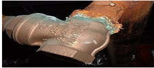
Figure (II.3) : Corrosion galvanique résultante d'un assemblage de deux métaux différents : robinet en cuivre et conduite en acier galvanisé.
