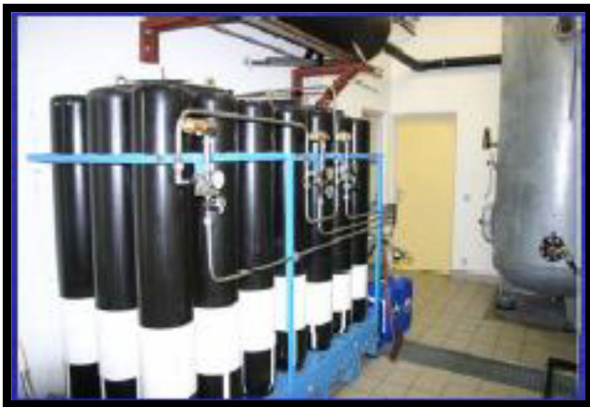
Figure 6: Le stockage d'air
