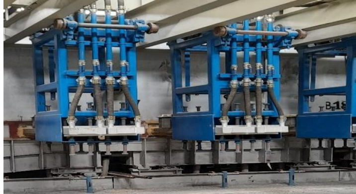
Figure II.13 : Refroidisseurs de sortie.
