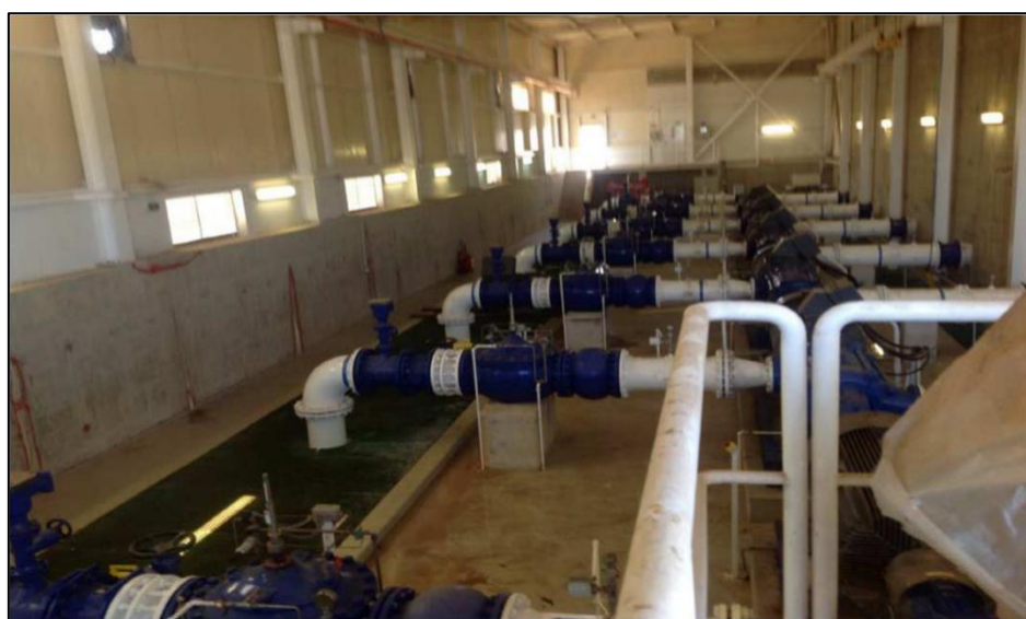
Figure II.27. Station de pompage d'eau traitée [17]
