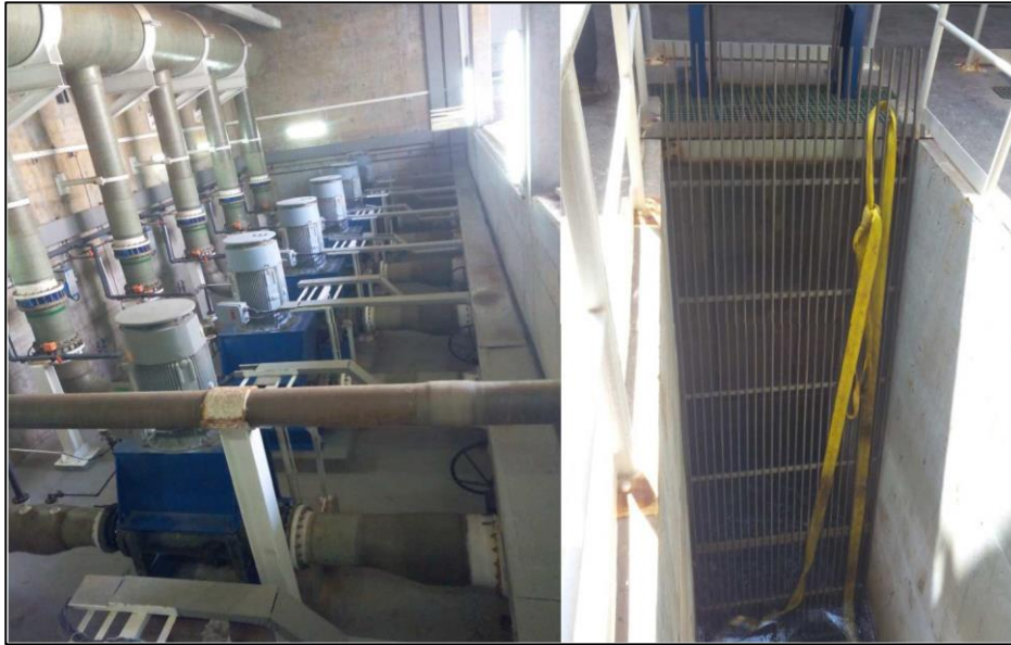
Figure II.11. Grilleurs et la station de pompage [17].
