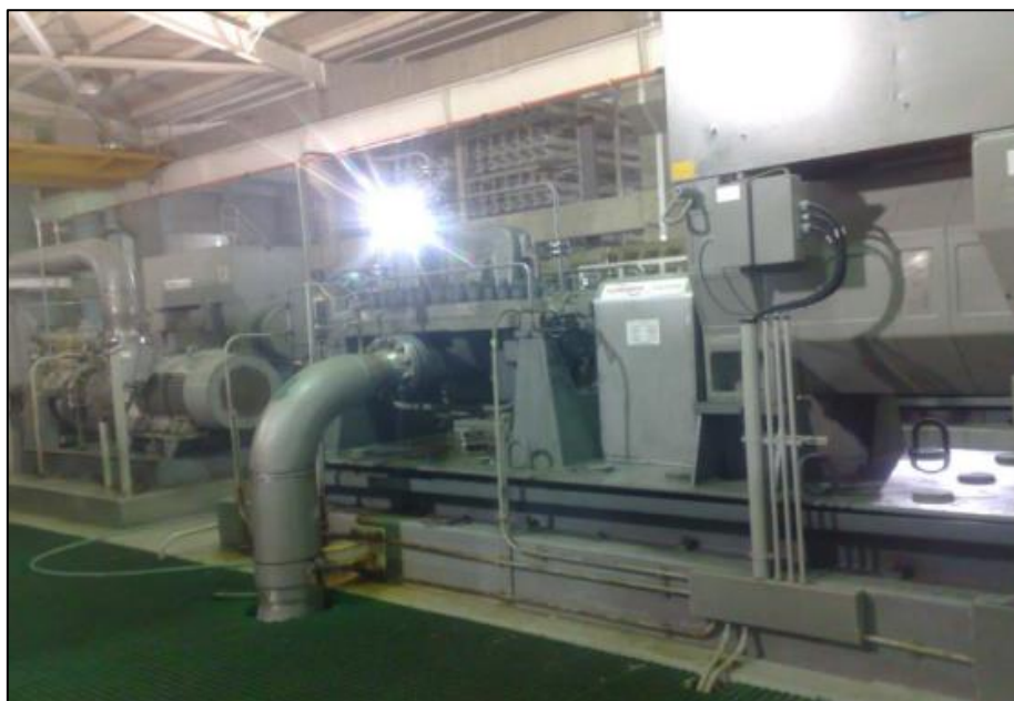
Figure II.20. Pompe haute pression au niveau de la station de Fouka
