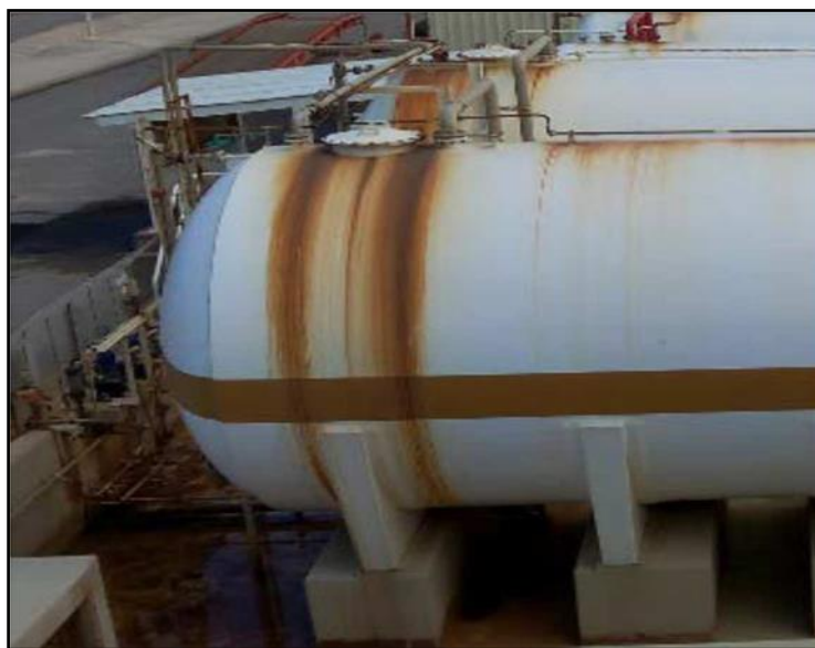
Figure III. 1. Quelque signe de corrosion au sien de la station
