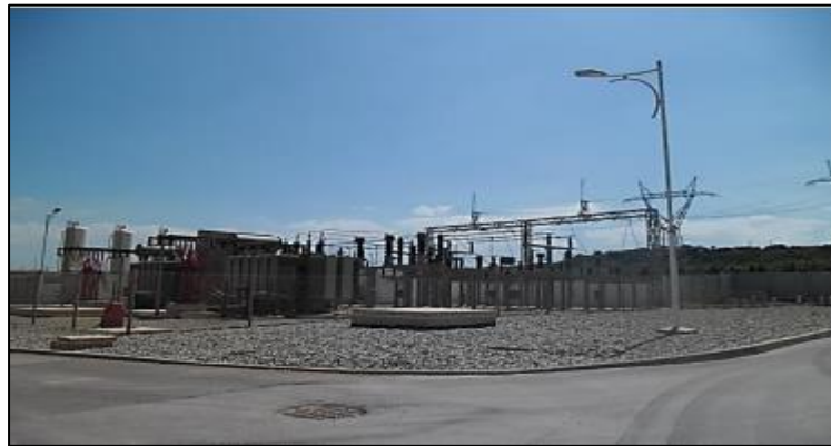
Figure II.28. Sous station électrique
