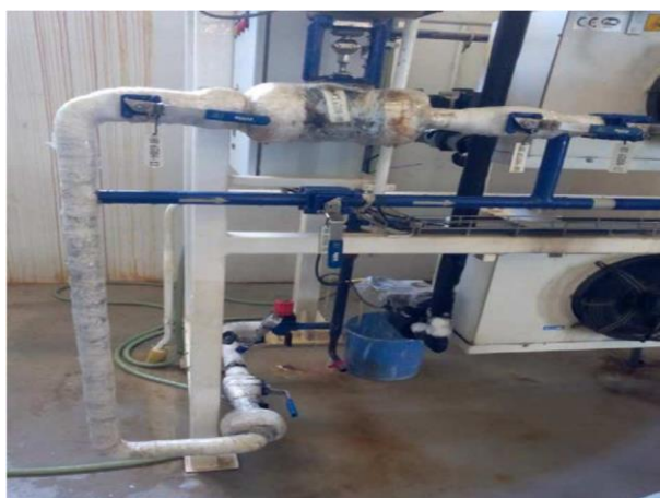
Figure III. 2. Congélation des tuyaux.
