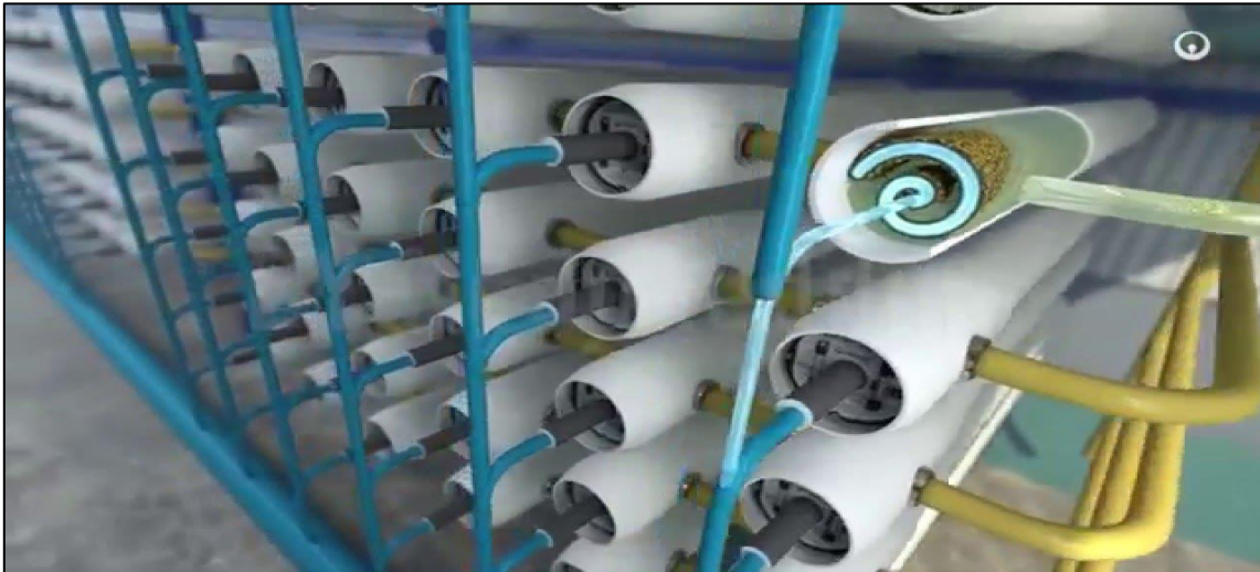
Figure II.17. Photographie montrant le système de dessalement par osmose inverse
