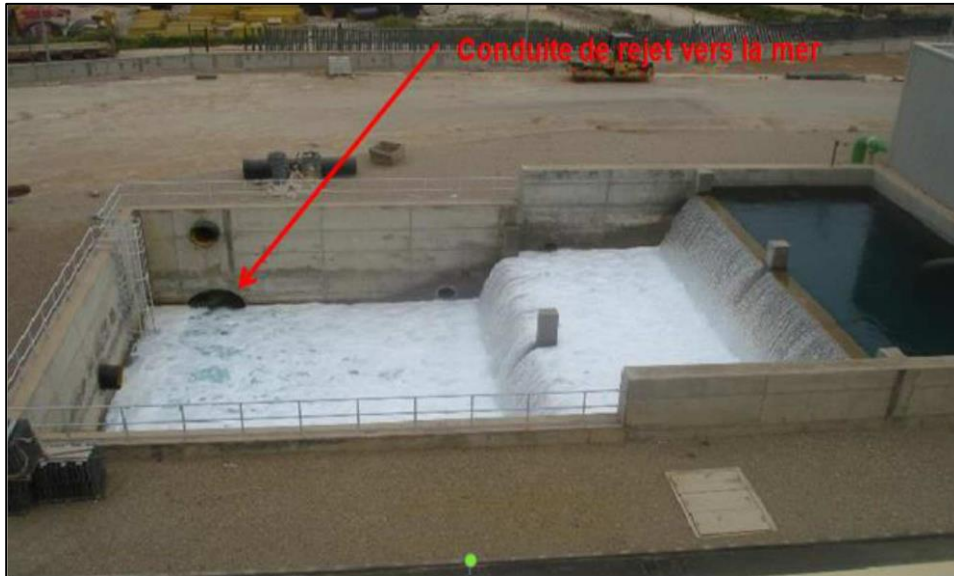
Figure IV. 1. Conduite de saumure vers la mer
