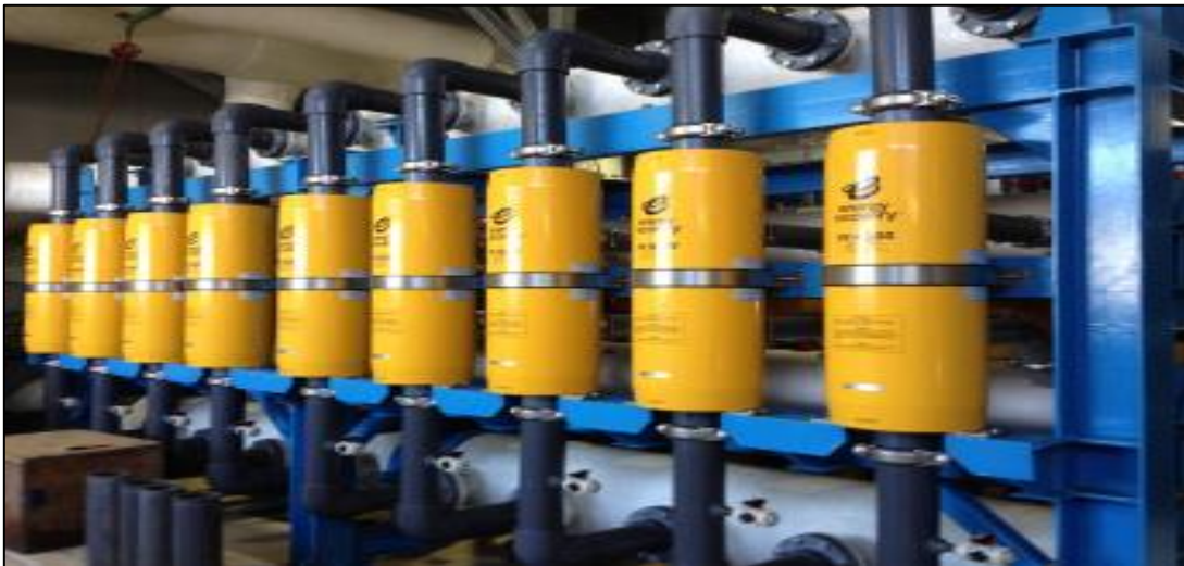
Figure II.21. Système de récupération d'énergie de la station de Fouka
