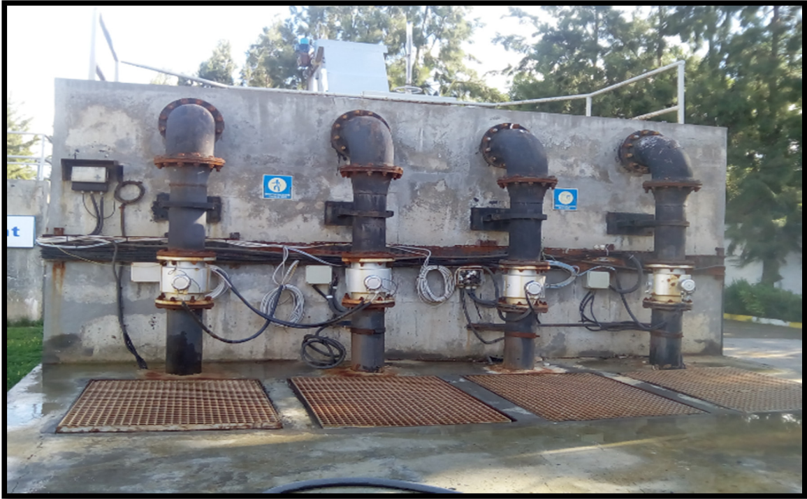
Figure 05 : Le poste de relevage (vue du devant).
