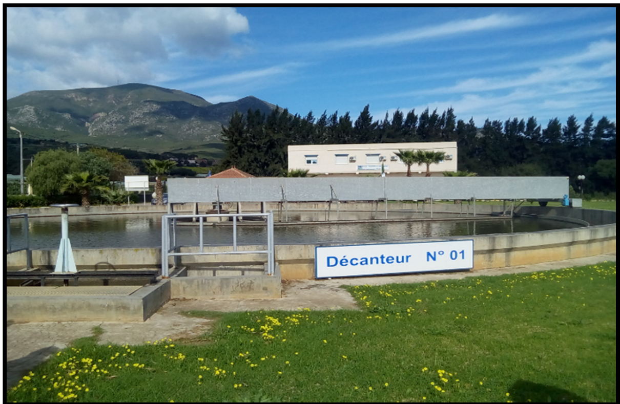
Figure 12: Le décanteur primaire.
