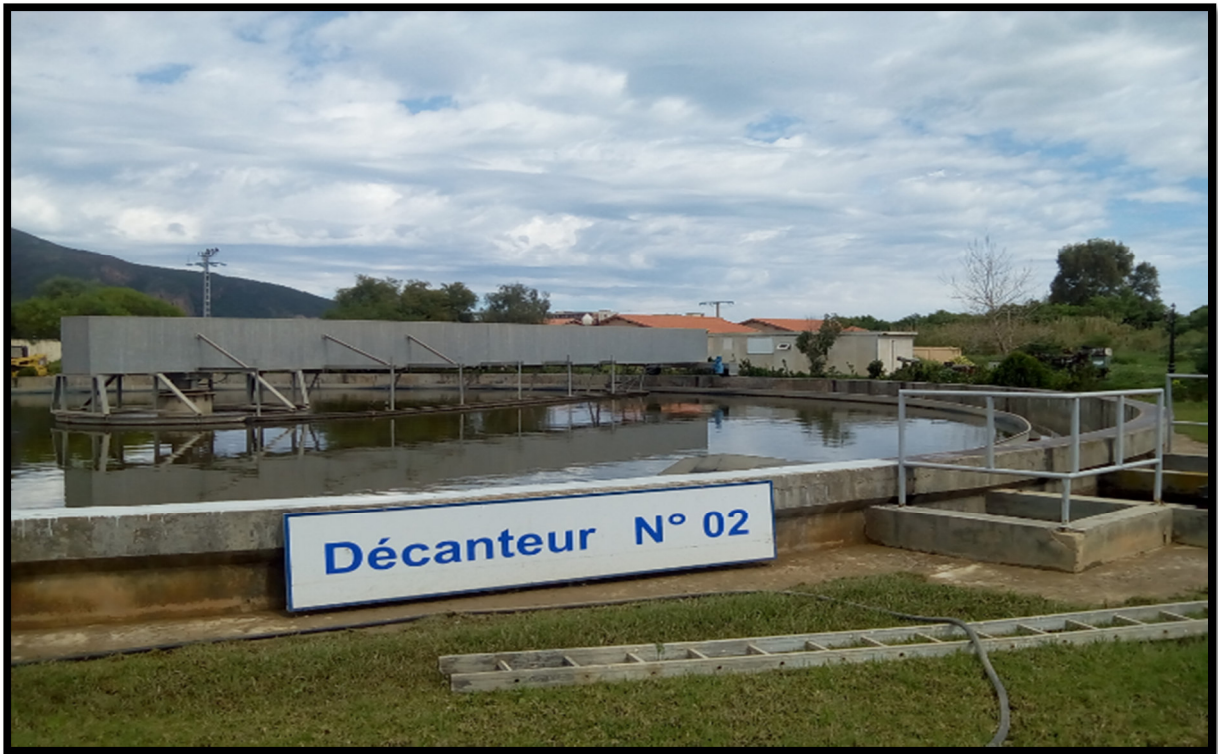
Figure 13 : Le décanteur secondaire.
