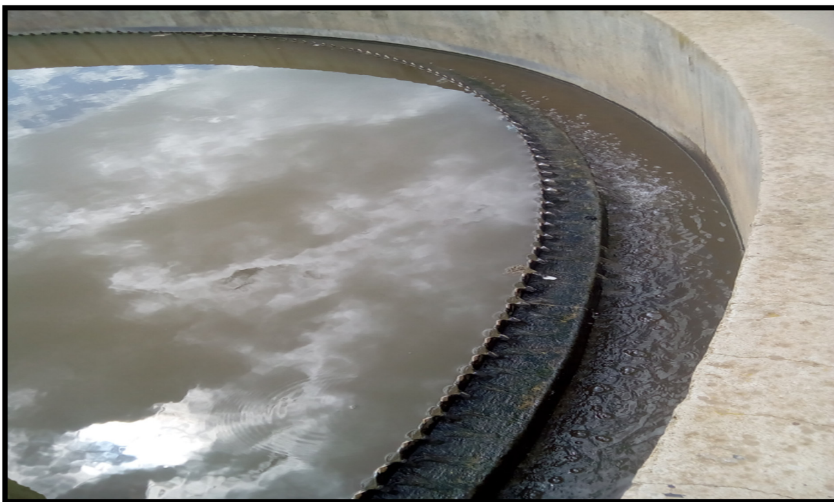
Figure 14 : L'épaisseur des boues.
