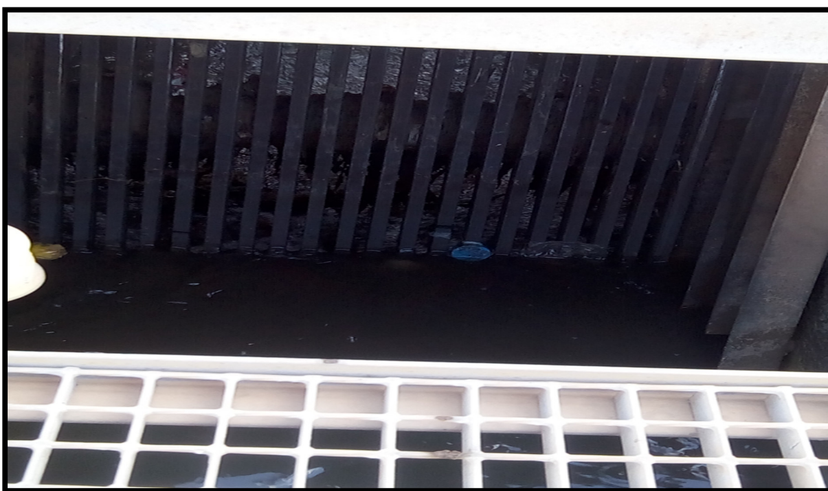
Figure 07 : Le dégrilleur fin.
