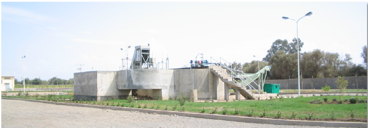
Figure 04 : Bloc des traitements physiques (dégrillage grossier et fin ainsi que dessablage / déshuilage) de la STEP de la ville de Hadjout (photooriginale).
