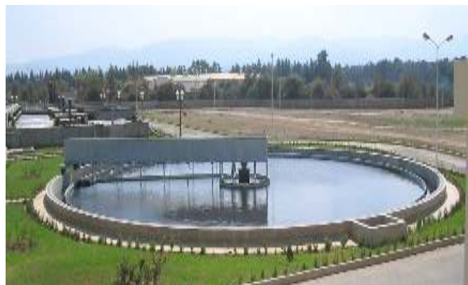
Figure 08: Décanteur secondaire(Photo originale)
