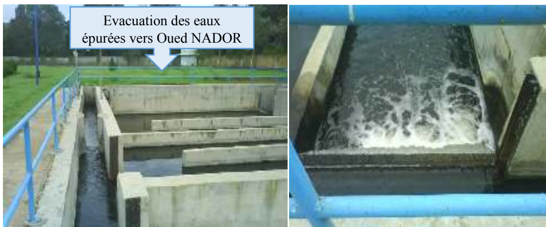
Figure 10 : Bassin de chloration(Photo originale)
