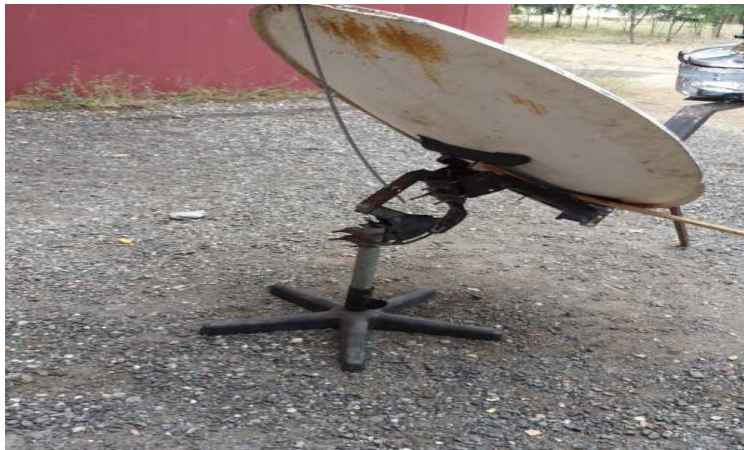
Photo IV 2 : Photo de support de parabole
