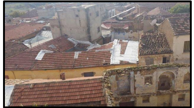
Figure 18 : habitation état dégradé de la Medina Source : Photo personnelle.
