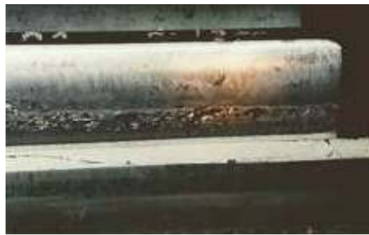
Figure II-15 : Rupture par écaillage.
