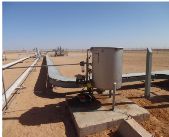
Figure 5.68: Le système d'injection d'inhibiteur de corrosion
