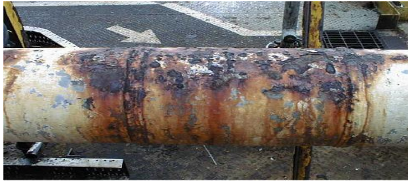
Figure 5.58: Corrosion externe d'un pipeline exposé à l'air[10]
