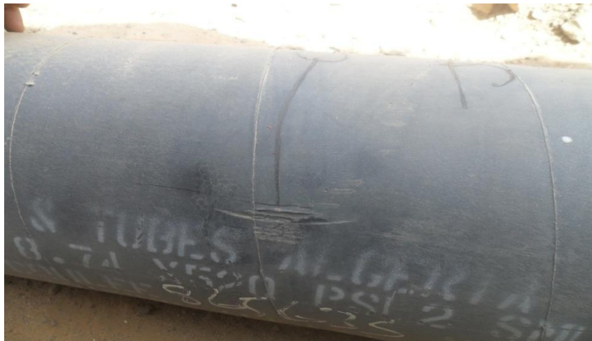
Figure 3.39 : Enrobage endommagée d'un gazoduc
