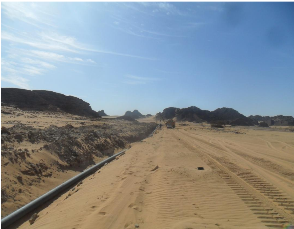
Figure 6.80 : Gazoduc 10" dans le projet ILLIZI-DJANET
