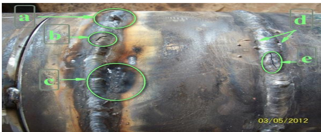
Figure 3.34 : Cordon de soudure avec les défauts (cratère, morsures/caniveaux, Fissure, Amorces d'arc). [11]
