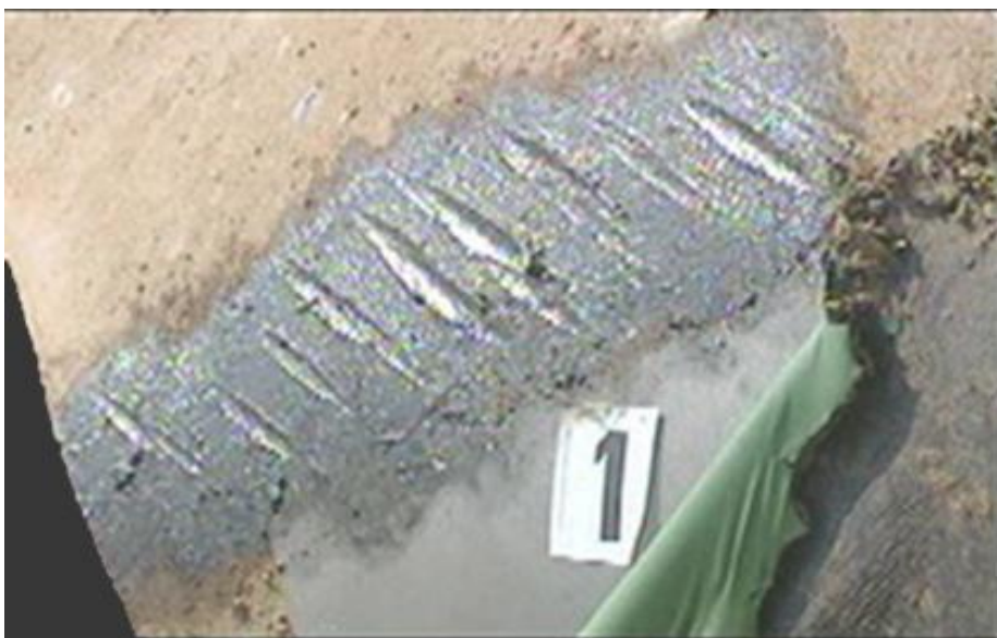
Figure 4.45 : Exemple de pipeline contenant une entaille [15]
