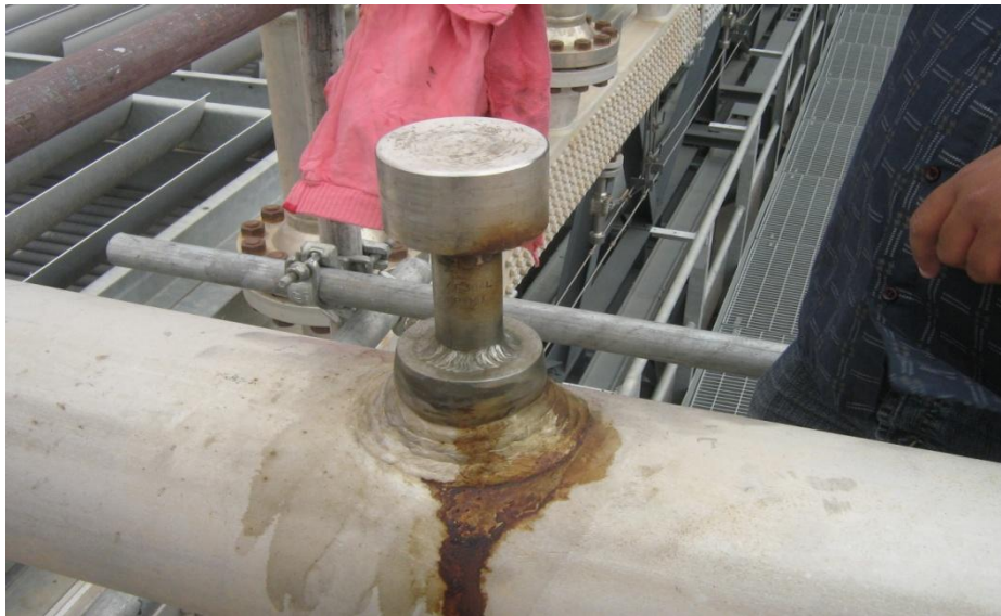
Figure 3.27 : Nettoyage d'un Piquage fissuré d'une ligne
