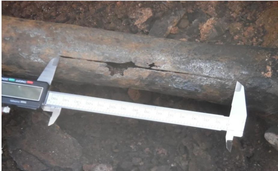
Figure 4.42 : agressions corrosives sur la paroi externe d'une canalisation métallique
