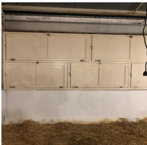
Figure 27 : Humidificateur vu interne (photo personnelle, 2024)
