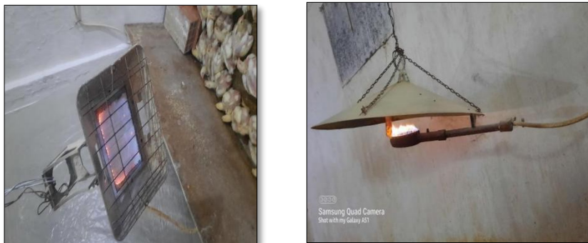
Figure 29 : Chauffage de type radiant à gaz (Photo personnelle. 2023)
