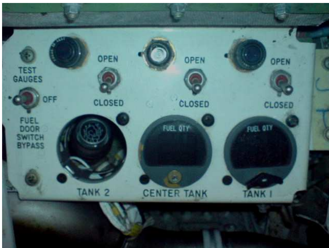
Figure (III.5) : Panneau de commande du remplissage carburant
