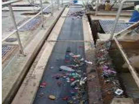
Fig.6 Dégrilleur manuel (Photos originale)
