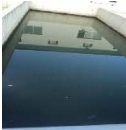
Fig.11 Lit filtrant de sable (photo originale).
