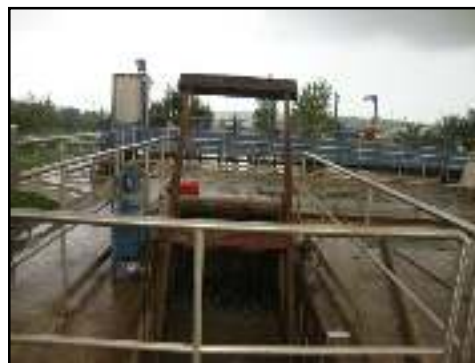
Fig.5 Dégrilleur automatique (Photos originale)
