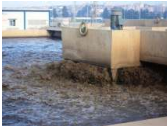
Fig.9 Bassin d'aération (Photo originale) .
