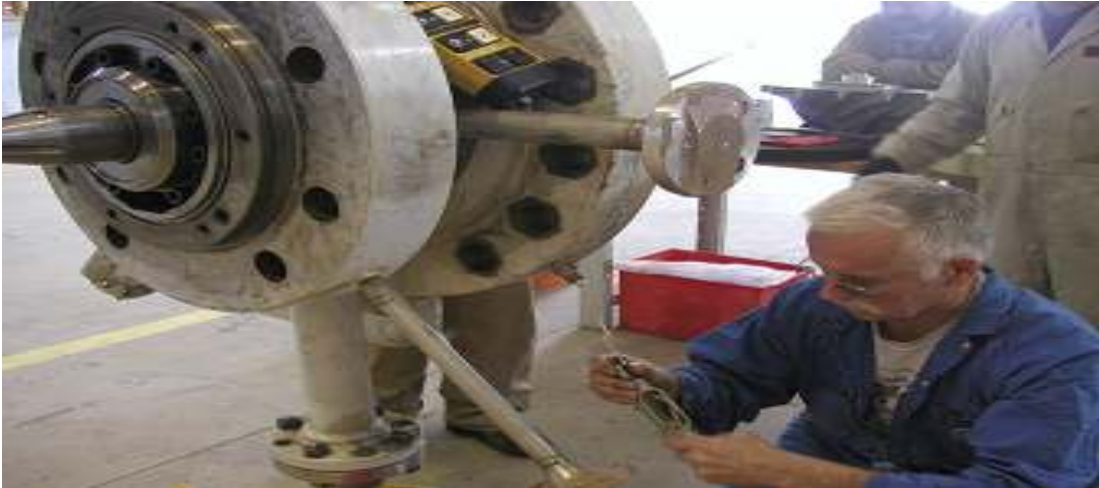
Figure IV.5: Démontage des sondes de températures de deux paliers .
