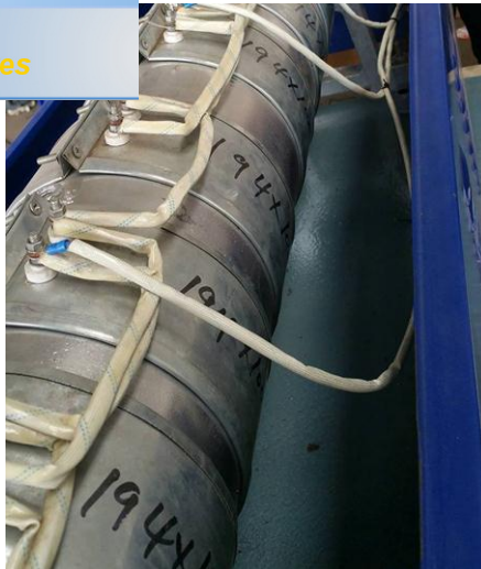
Figure III ó 15 : Exemple des colliers chauffant d'une Extrudeuse
