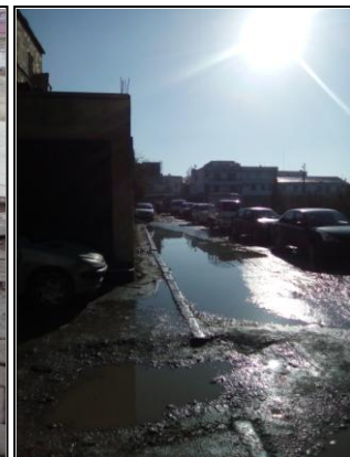
Figure3-38 voie étroite dégradée
