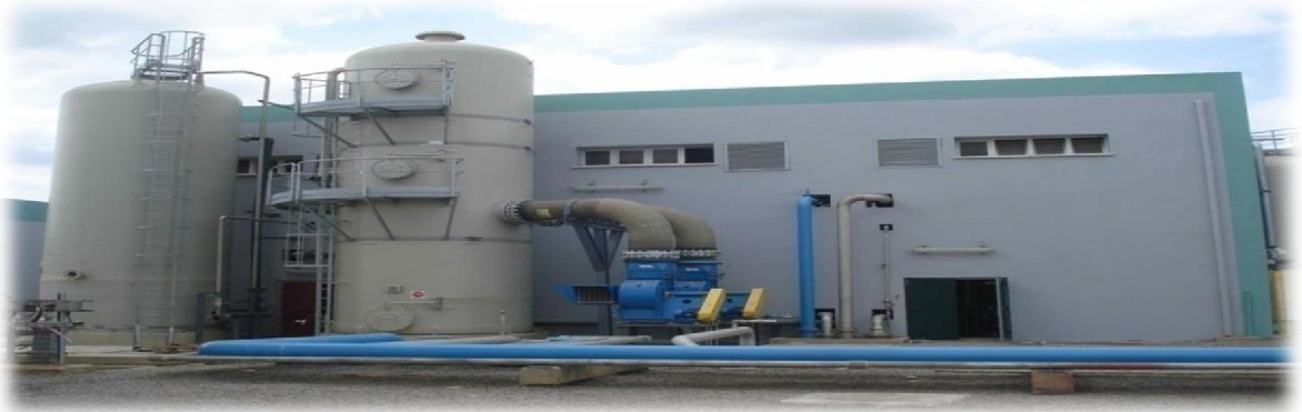
Figure I.16: Station de production d'eau déminéralisée
