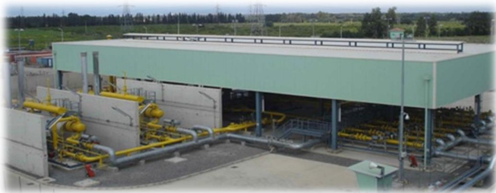
Figure I.13: poste de distribution du gaz principal
