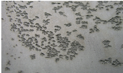
Figure I.4 : Corrosion par piqûres
