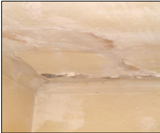
FIG 09 : Infiltration directe par le toit.
