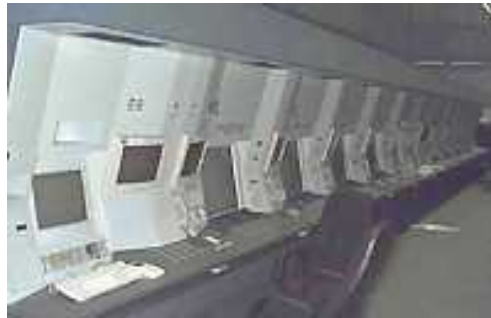
FIG.V.13 – Nouveaux postes informatiques
