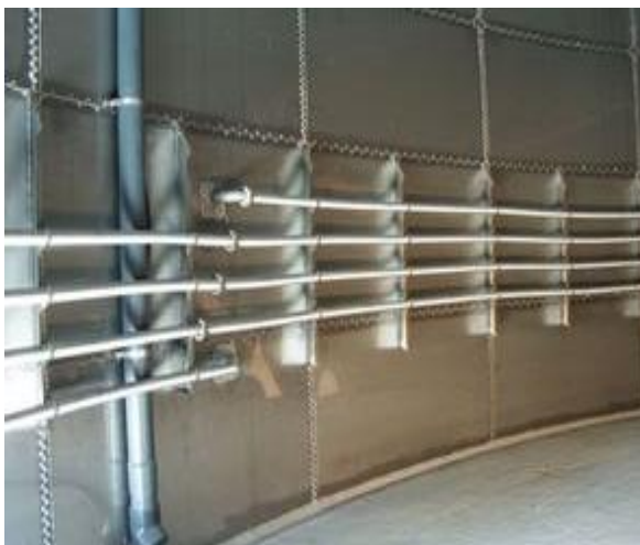
Figure I.7 : Système de chauffage à l'intérieur d'un digesteur.
