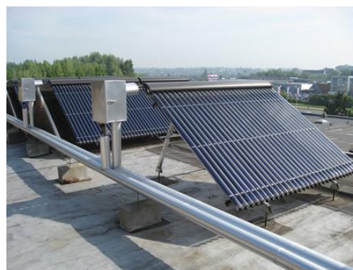
Figure 34 Des panneaux solaires installés sur le toit de hôtel
