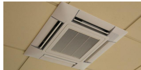
Figure n°=30 Bouche de soufflage
