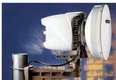
Figure 1.6 : Une installation faisceau hertzien (la radio + l'antenne directive)
