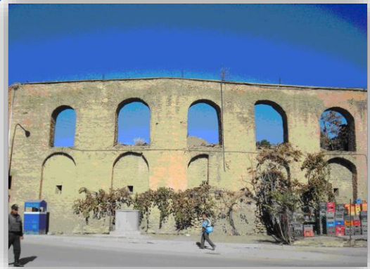
Fig.: Aqueduc en état de dégradation
