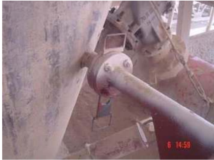
Figure 2.2 : Injection du gaz naturel au fond du cyclone 3
