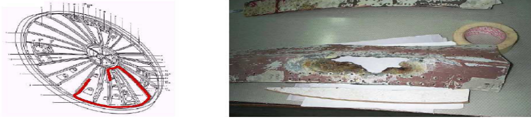
Figure I.4 : corrosion au niveau de cloison.
